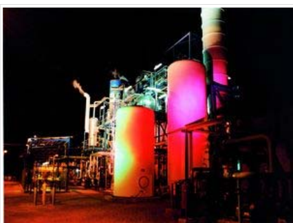
Planta de cogeneración 'Tesa'
